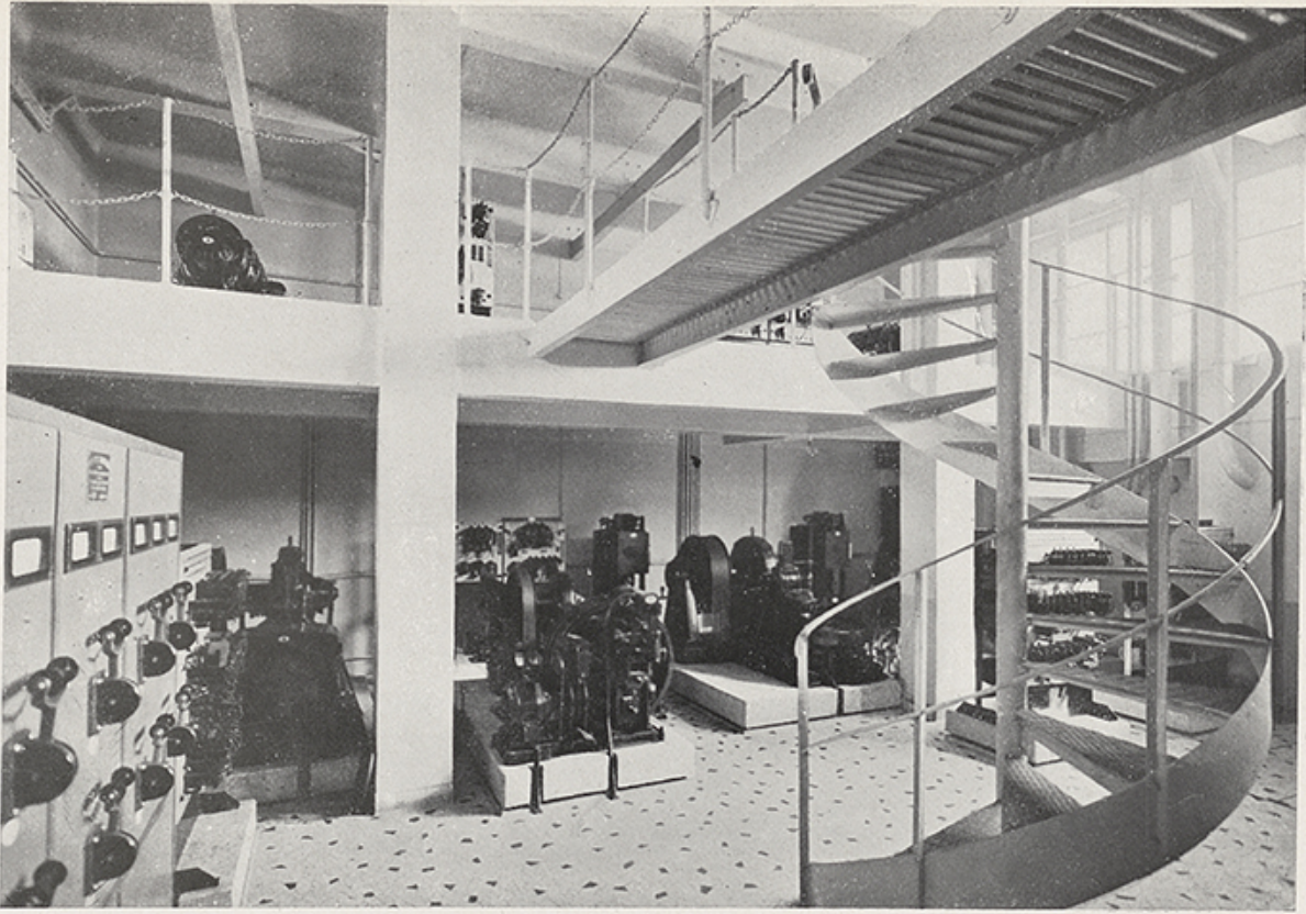
MACHINERIE DES ASCENSEURS - DOUZIEME ÉTAGE
